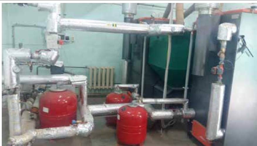
5.attēls. Apkures katls (Foto: Valda Gudynaitė-Franckevičienė)
