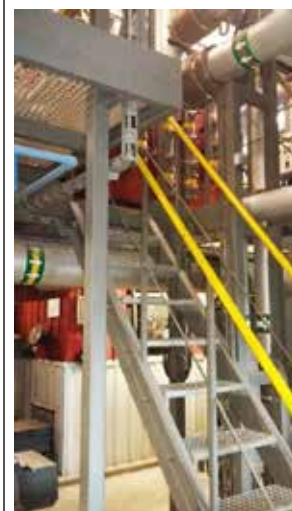
2.attēls. Apkures katls (Foto: Vidmantas Verbyla)
