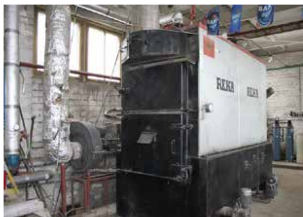
8.attēls. Apkures katls Muhu Liiva katlu mājā G
