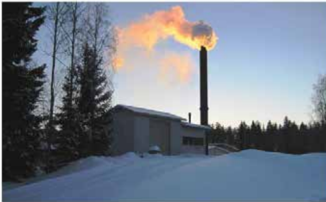
Picture 1. Yläkylä Heating plant
